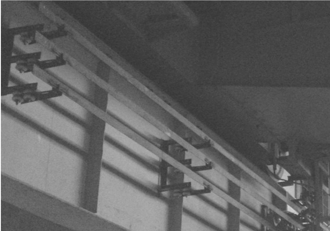
Рис. 2. Троллеи мостового крана с коррозионным повреждением
